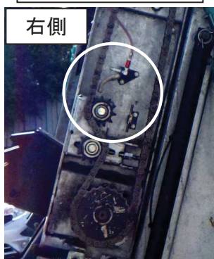
自動注油箇所
